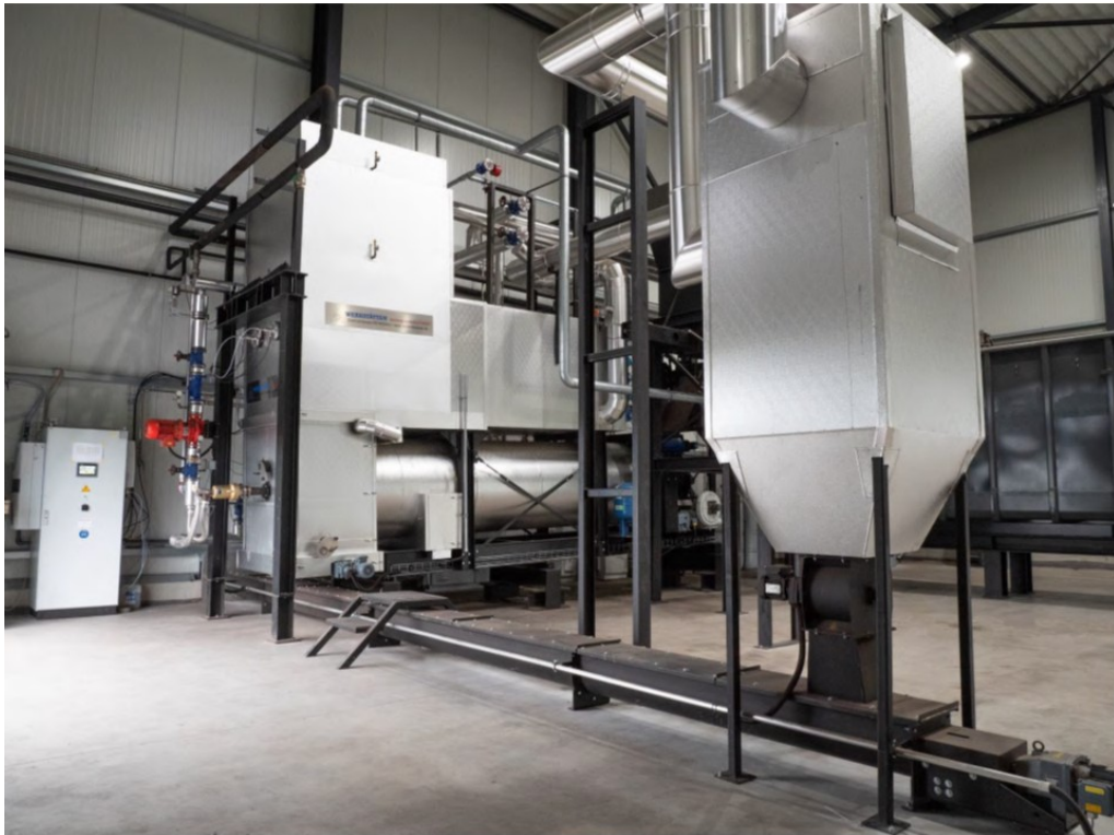
Abb. 3-11: Drehrohfen mit Abgasreinigung, Referenzanlage Schüttorf, Foto: WERKSTÄTTEN Heating Systems GmbH
