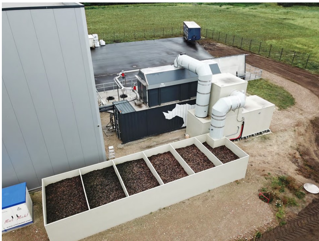
Abb. 3-10: Trockner mit Abluftbehandlung, Referenzanlage Schüttorf, Foto: WERKSTÄTTEN Heating Systems GmbH
