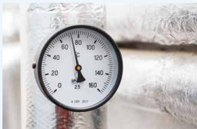
Die Temperaturanzeige gibt Auskunft über die Temperatur im Wärmespeicher. (Foto: vladdeep / stock.adobe.com)
