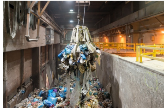
Müllbunker im MHKW Darmstadt
