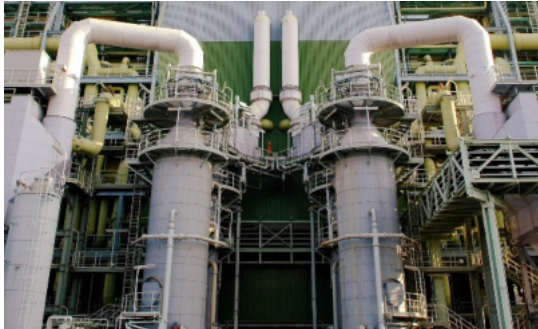
Klärschlammverbrennungsanlage im Industriepark Höchst
