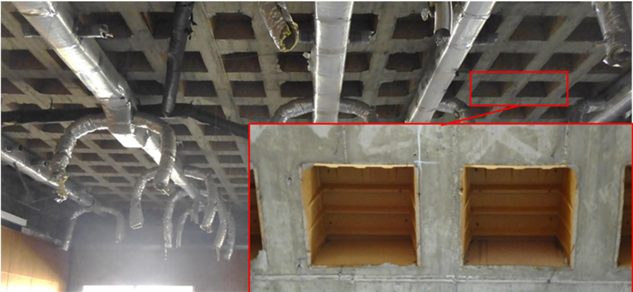
Abb. 36: Herausforderung der getrennten Erfassung: Verlorene Schalung aus Holz mit Styroporresten in der Betonkonstruktion (Rippendecke des Ratssaals), Foto: Dilan Glanz, Universität Kassel
