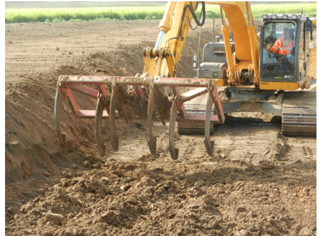
Lockerung des Planums vor Bodenauftrag mit Tiefengrubber. Ein Wechsel zwischen Baggerlöffel und Tiefengrubber ist mittels Schnellkupplung leicht möglich. © Gerhard Dumbeck
