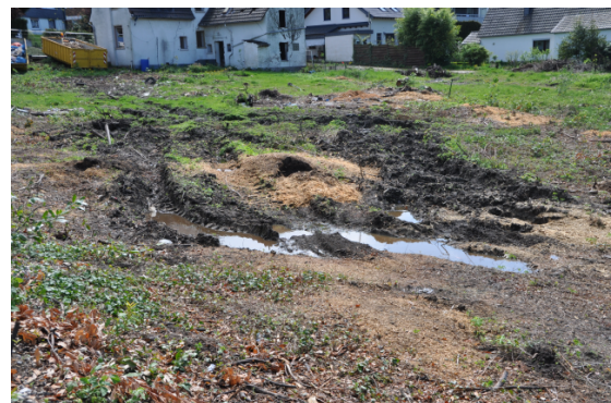
Bei der Baufeldfreimachung stark verdichteter Boden mit tiefen Fahrspuren. Hier wurde keine Vorsorge betrieben.
